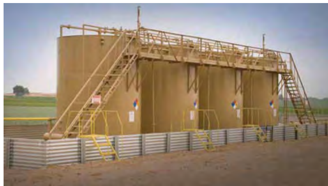
Рис. 5. Когда сырая нефть хранится в резервуарном парке, вероятность выделения паров в атмосферу очень высокая. Система получения паров, которая относится к поршневому газовому компрессору Blackmer, может захватывать эти пары и работать с высокой надежностью и дополнительными годовыми доходами
